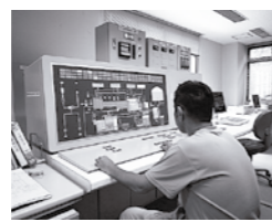
24時間安定して配水しているか管理しています。
